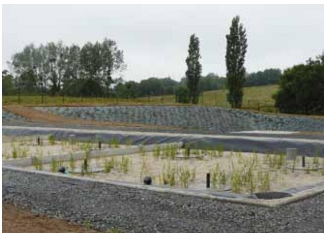
Station de Contrières : les filtres plantés de roseaux
